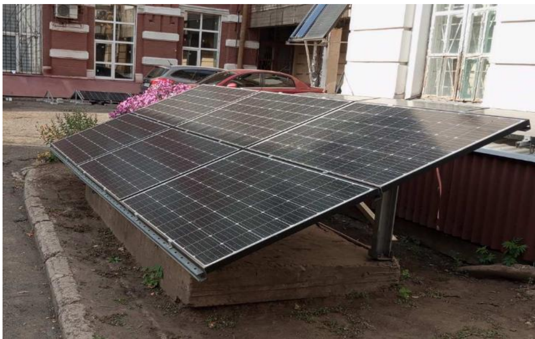
Рис. 1.2 СФП розміщені на спеціальних стійках на земельній ділянці
